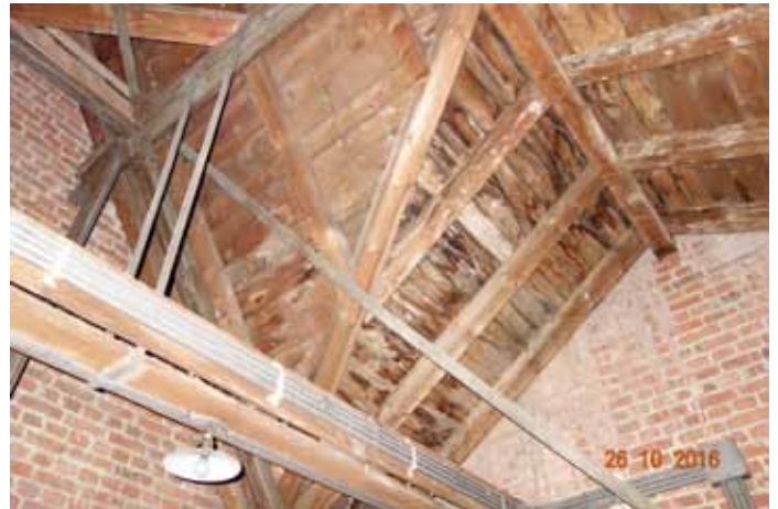
Durchfeuchtung Dachschalung Bereich Hauptkehle und angrenzender Dachfläche Foto: T. Heinrich
